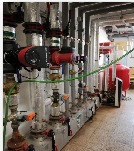
Výměňková stanice v Písku
